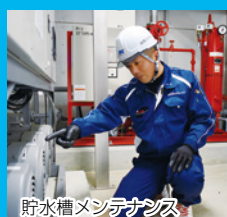
貯水槽メンテナンス
